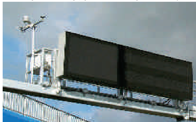
Stacja meteo na DTŚ
