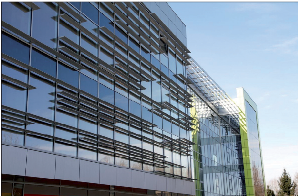
Rys. 3. Fotografia PNT „Silesia” z zainstalowanymi panelami PV (automatyczne rolety zewnętrzne) Foto. 3. PNT „Silesia” photograph with installed PV panels (automatic external blinds)
