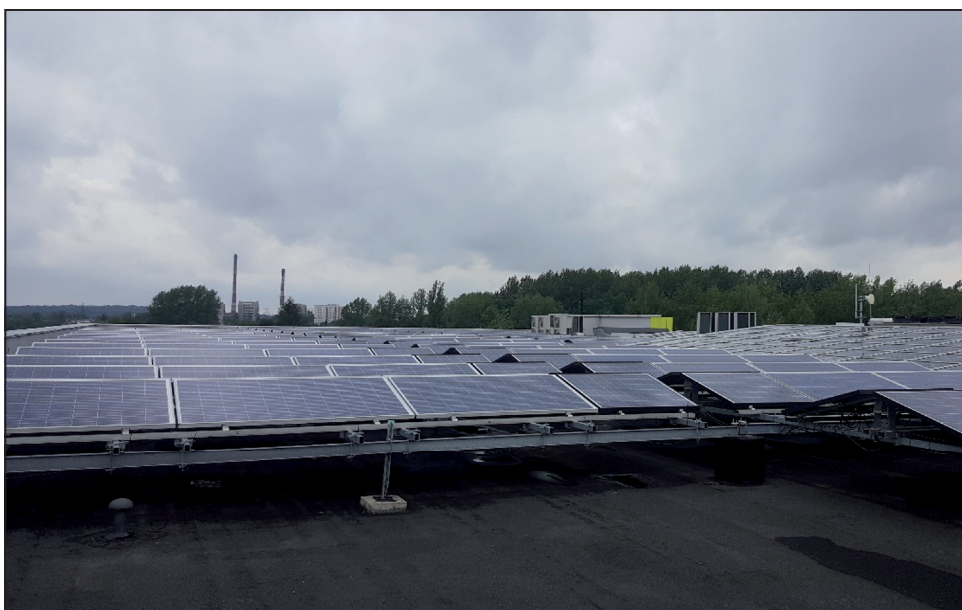
Rys. 5. Fotografia PNT „Silesia” z zainstalowanymi panelami PV (dach) Foto. 5. Photographs of PNT „Silesia” with installed PV panels (roof)
