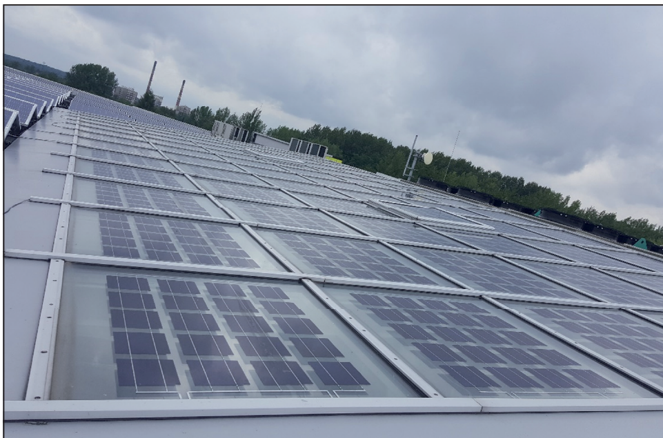
Rys. 6. Fotografia PNT „Silesia” z zainstalowanymi panelami PV (duży świetlik) Foto. 6. Photograph of PNT „Silesia” with installed PV panels (large skylight)
